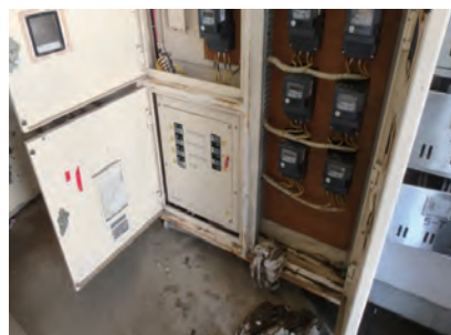
階段室ブレーカー等の浸水状況（鯨岡団地）
